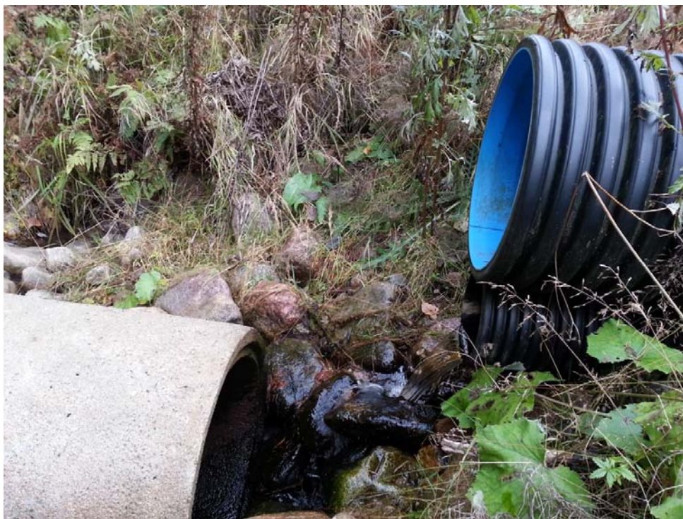
Heinämäenojan pisteellä 6 on rumpuja päällekkäin. Vesi virtaa 21.10.2015 vain alimmasta putkesta.
